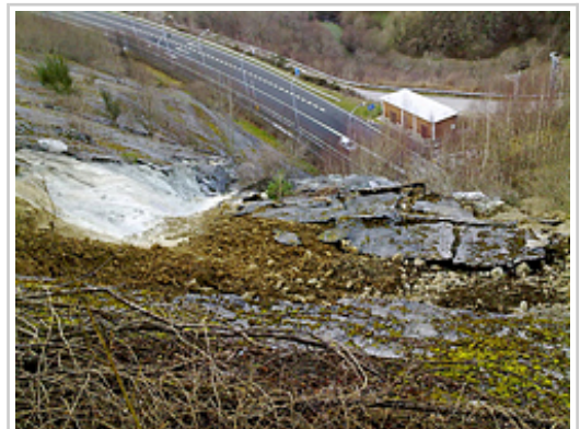
Desprendimiento en el desmante de la ladera en la zona de la boca sur del túnel de Almandotz.
