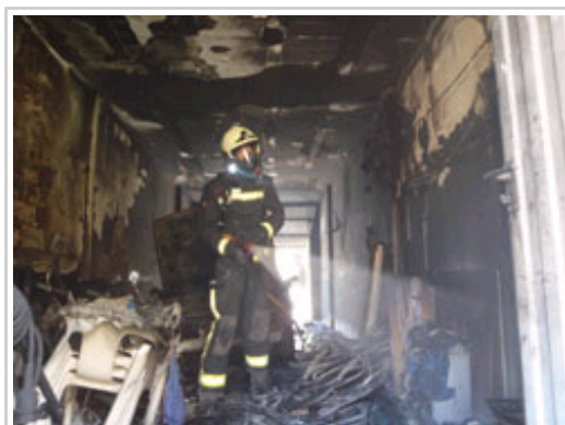
Un bombero inspecciona el garaje incendiado.
