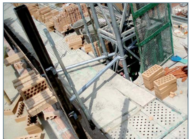
Peligro: obstáculo fijo en el recorrido del andamio.
