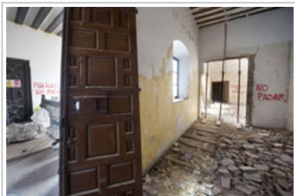
Se ha procedido a la señalización de los riesgos estructurales del edificio.
