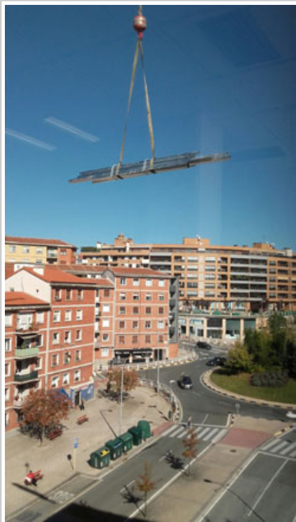
Parte de los componentes de la instalación.
