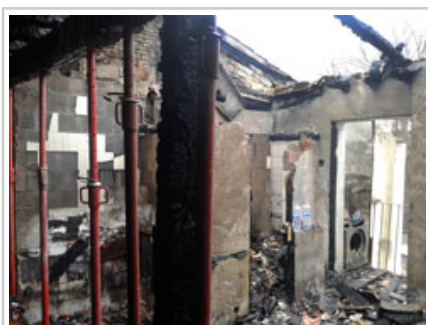
Imagen de la 5ª planta, cuya estructura ha sido apuntalada.
