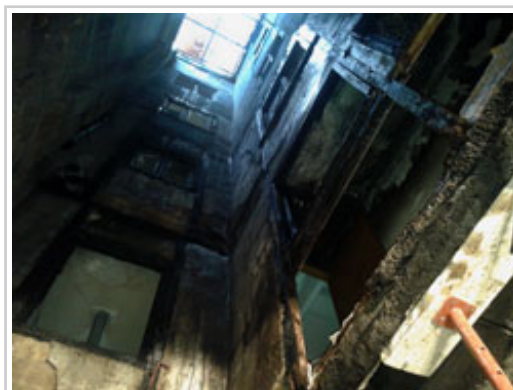
Huellas del fuego en el patio interior.
