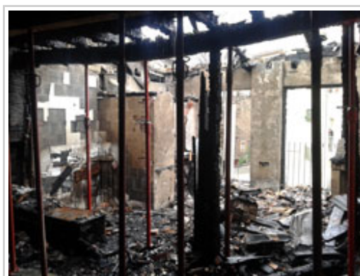
El tejado se ha hundido.
