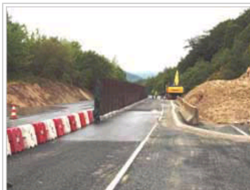
Imagen del tramo de la carretera, tras los trabajos parciales de limpieza.
