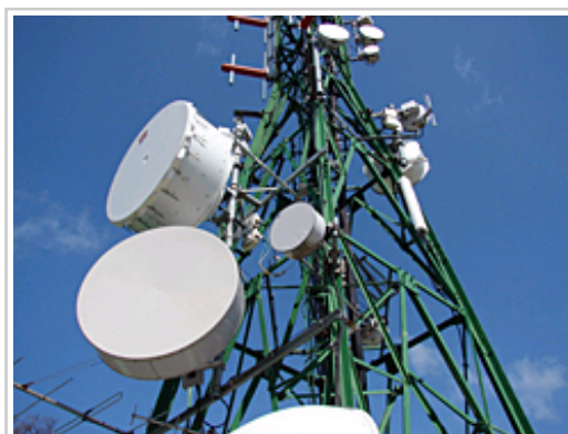
Centro de telecomunicaciones de Ibañeta, gestionado por NASERTIC.
