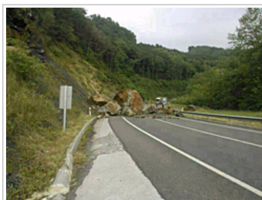
Piedras caídas sobre la calzada de la N-121-A, a la altura de Bera.
