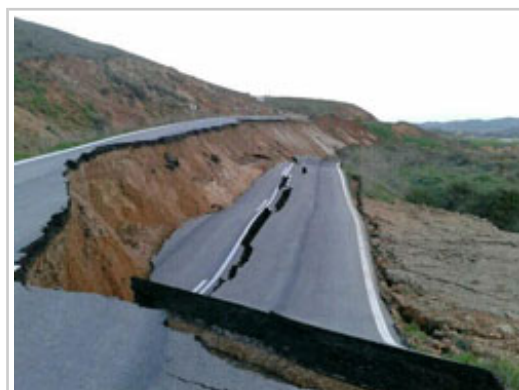
La carretera NA-6100, hundida a causa de un desprendimiento en Vergalijo.
