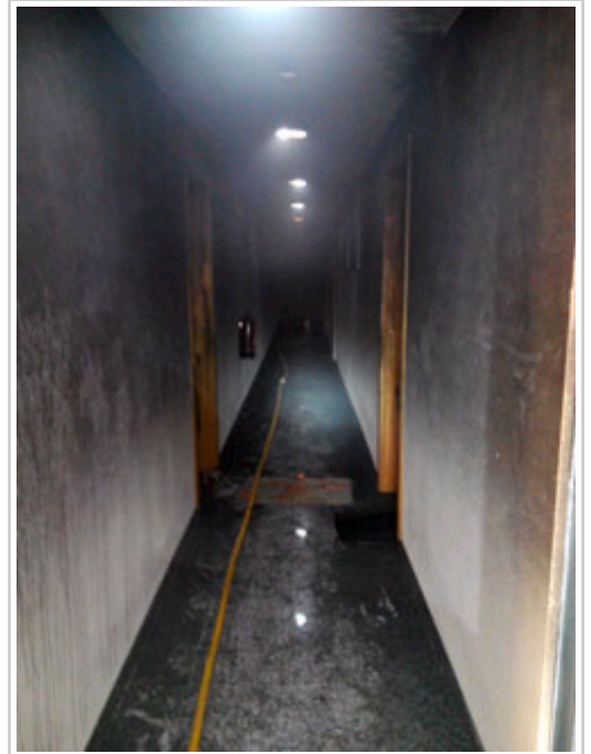
En el pasillo del rellano del 8º piso eran visibles los efectos del humo.
