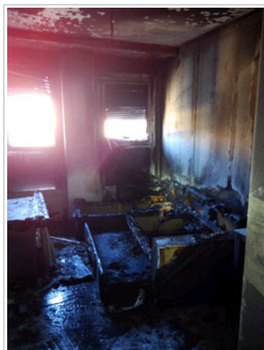
El fuego ha causado daños de consideración.
