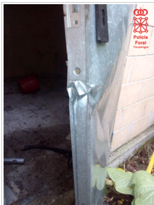
Estado en el que quedó la puerta por la que entraron a la nave
