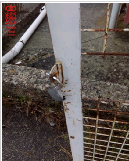
Candado cortado de la puerta de acceso a las instalaciones
