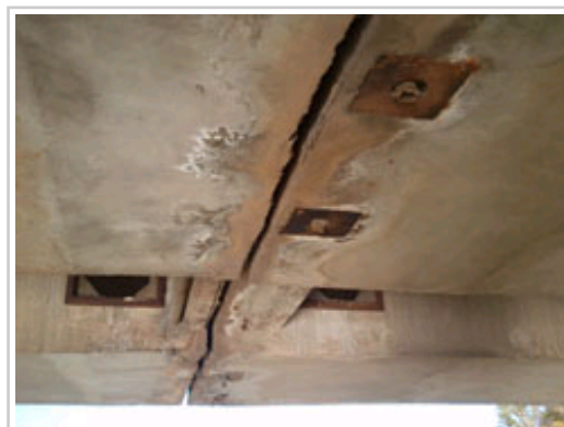
Vista central de la unión de la parte central del puente con las piezas deterioradas.
