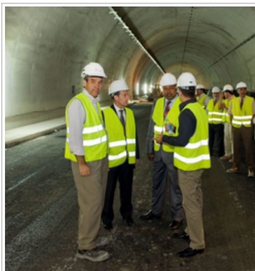
En el interior del túnel en obras de la Autovía de Jaca, Amador Mariscal, jefe de obra, Anai Astiz, Consejero de Fomento y Vivienda, Alimamy P. Coroma, Ministro de Obras Públicas de Sierra Leona Y Eduardo Sanzol de Naxan.
