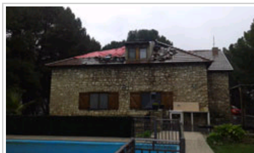
El incendio ha dañado el tejado.
