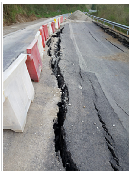
Estado de la carretera antes de la actuación
