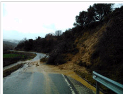
Deslizamiento de talud en la NA-5110, Pueyo-Alto de Lerga.
