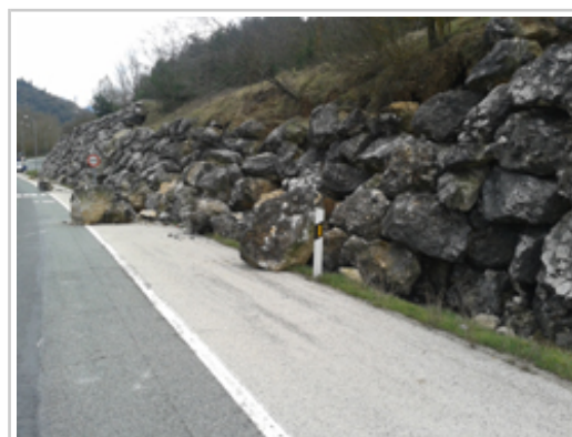
Desprendimiento de rocas en la escollera de Arre.
