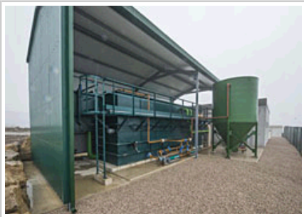
La planta de tratamiento de agua potable de Urroz-Villa.
