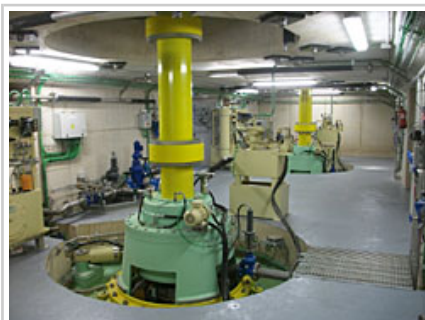
Nafarroako Ubidearen harguneko zentral hidroelektrikoko turbina-gela.
