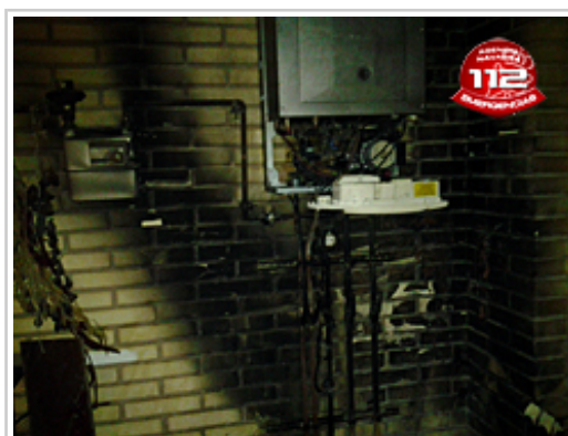
Caldera afectada por el incendio.
