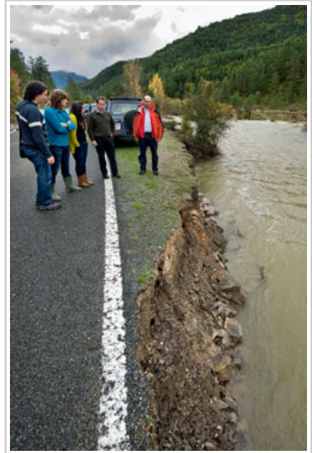
Carretera dañada por la riada en Vidángoz.
