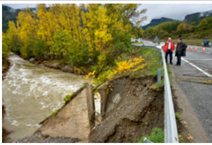
El consejero y el director general contemplan los destrozos en el puente del río Biniés, en Burgui.
