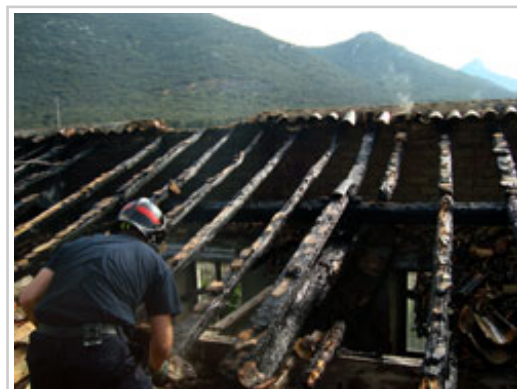
Un bombero observa el estado de las vigas del tejado.
