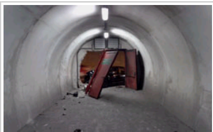
El vehículo visto a través de la salida de emergencia.
