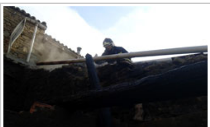
Un bombero trabaja en el tejado hundido.
