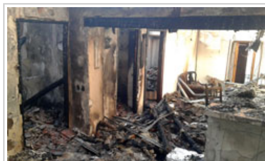
La primera planta ha quedado devastada por el incendio.
