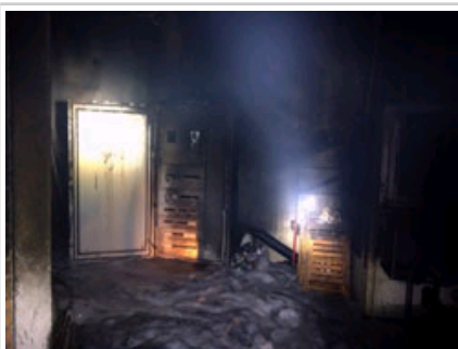
La instalación eléctrica ha quedado inutilizable.
