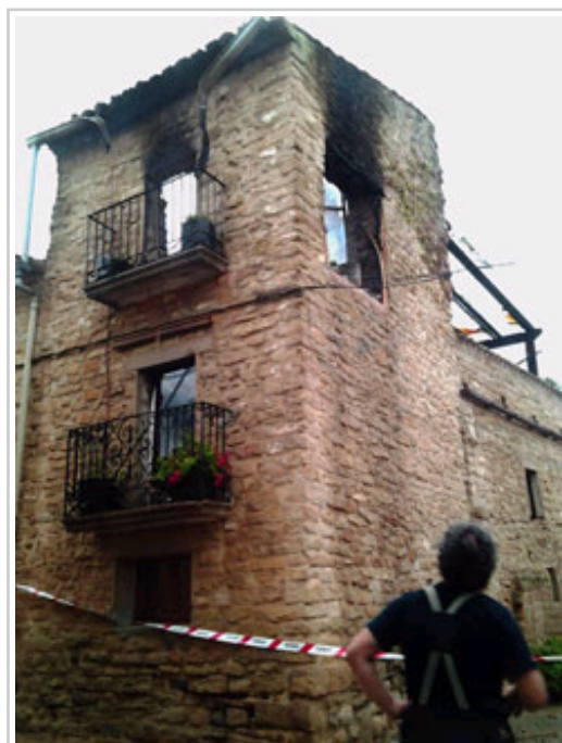
Se han mantenido en pie las paredes exteriores de piedra.
