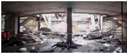
Vista de la zona que se ha derrumbado.
