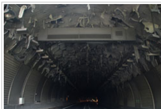
El revestimiento interior de la bóveda, desprendido a causa del incendio.
