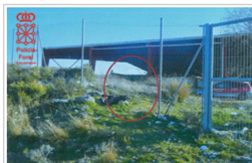
Agujeron practicado en la valla perimetral
